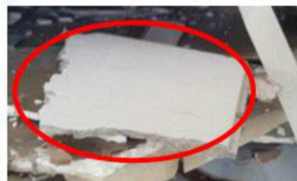
Morceau de plafond suspendu
